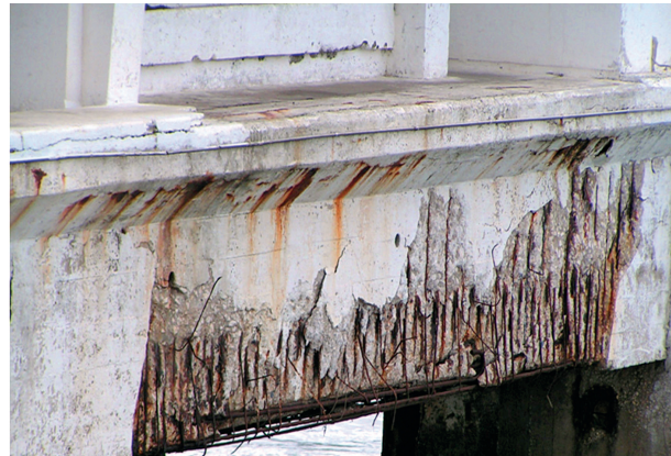
Obr. 9 Zkotodovaná výztuž mostního nosníku (uvedeno se svolením Dr. Kouřila, VŠCHT Praha)
